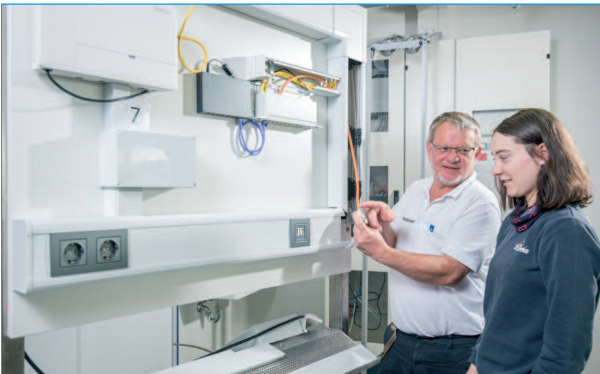
Installation von Telefonverbindungen über das Netzwerk mit einer VOIP-Telefonanlage
