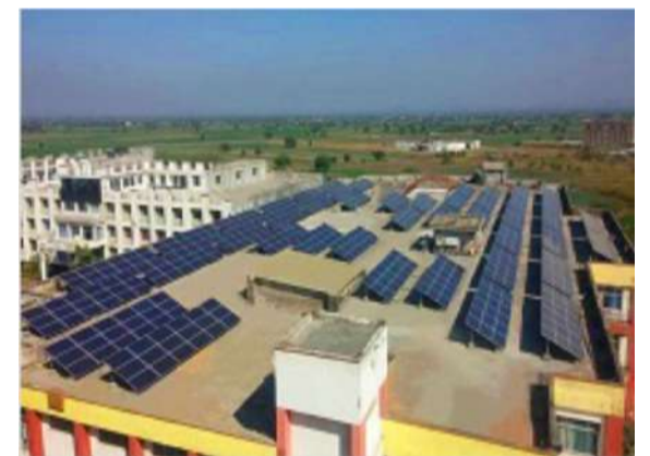
コクヨカムリン：パタルガンガ工場に設置されている太陽光パネル
