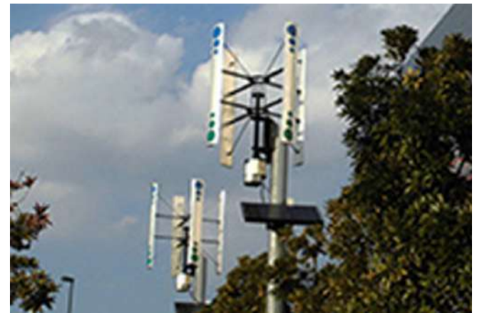
首都圏IDCに設置されているハイブリッド街灯
