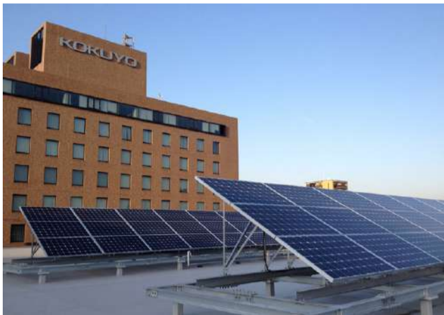
大阪オフィス新館に設置されている 太陽光パネル
