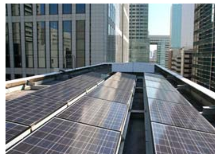
品川オフィスに設置されている太陽光パネル
