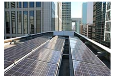
品川オフィスに設置されている太陽光パネル
