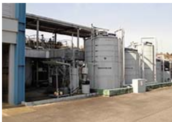
三重工場の排水処理施設
