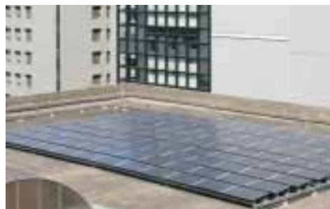
コクヨ東京品川ショールームの太陽光発電システム
