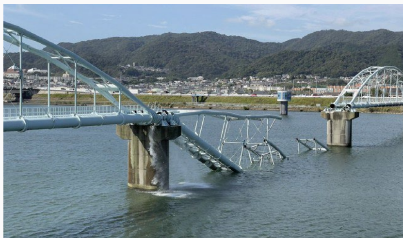
六十谷水管橋崩落事故
