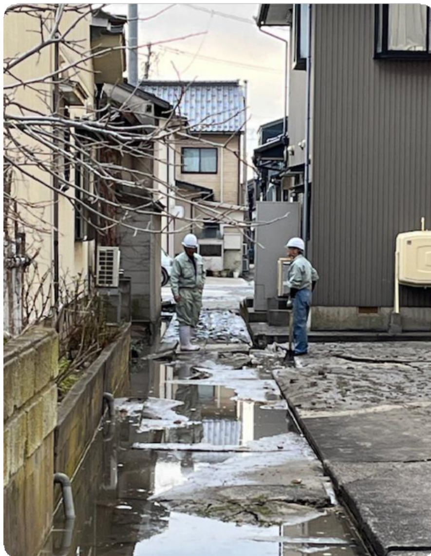
液状化が多発した地区での漏水調査
