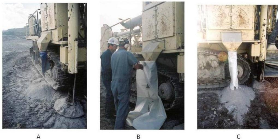
Рис. 3.13. Место сброса пыли до установки ограждения (А). Два человека устанавливают ограждение в месте выгрузки уловленной пыли (В). Место выгрузки после установки ограждения (С).
