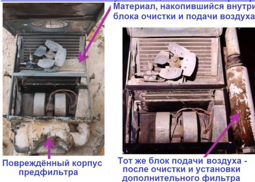
Рис. 9.6. У блока очистки и подачи воздуха (слева) не проводилось регулярное техобслуживание; справа показан тот же блок после очистки и установки дополнительного фильтра.
