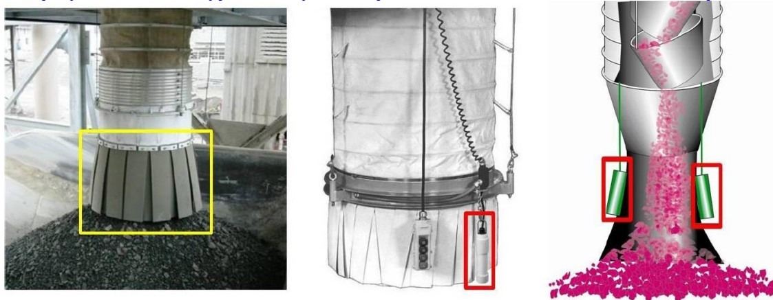
Рис. 7.4. Ограждение (в жёлтой рамке) и поворотные датчики (в красных рамках), установленные на конце устройства для выгрузки материала, и уменьшающие попадание пыли в воздух.
